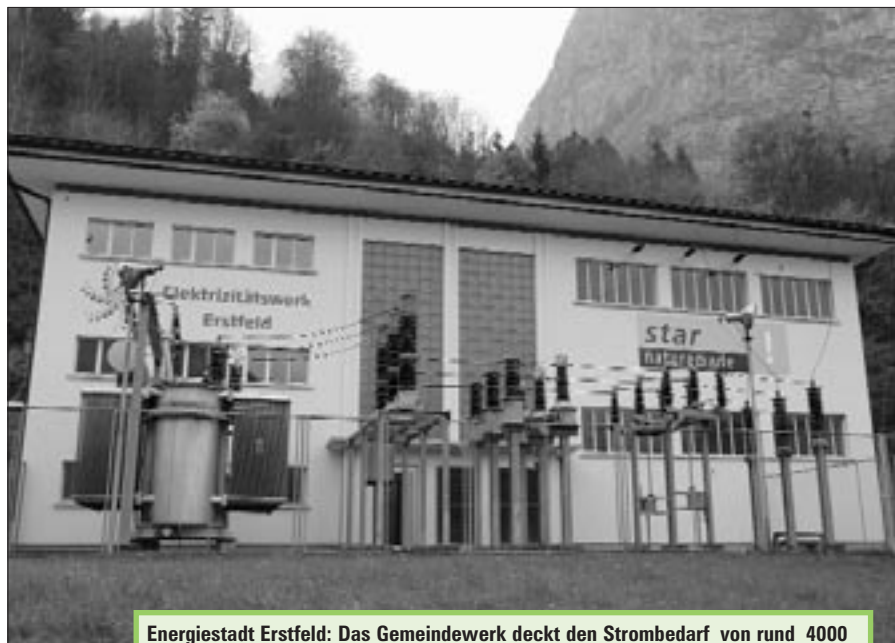
Energiestadt Erstfeld: Das Gemeindewerk deckt den Strombedarf von rund 4000 Einwohnern zu 70% mit naturemade-star-zertifiziertem Ökostrom.
