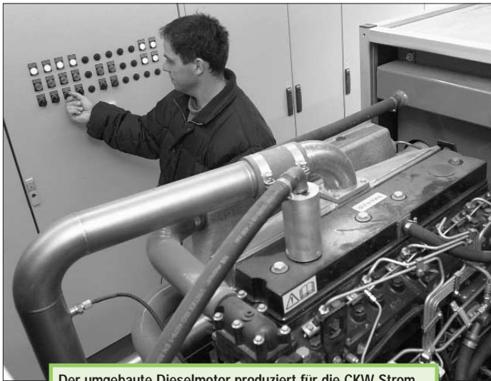
Der umgebaute Dieselmotor produziert für die CKW Strom.
